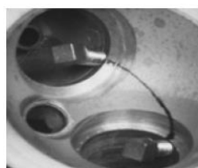
"Capture" la grieta
